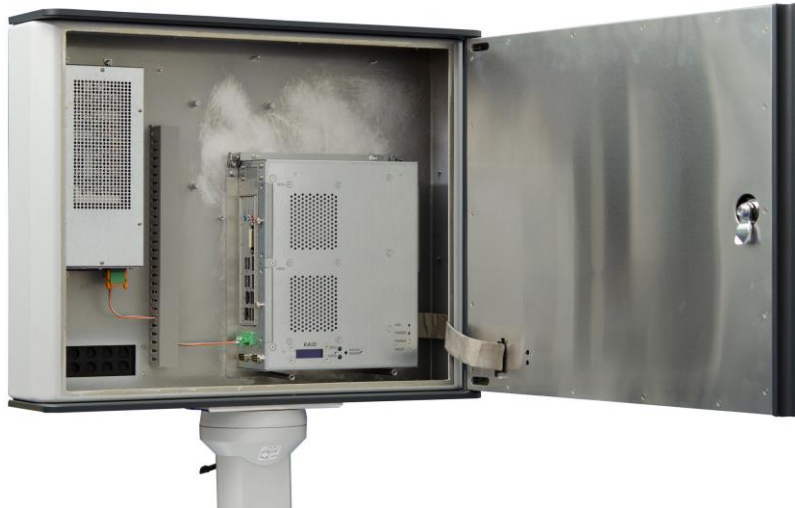
Fronttür geöffnet mit Blick auf PC-Kassette, Netzteilkassette, Kabeldurchführung und Anschluss der Frontelektronik
