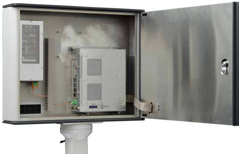
Fronttür geöffnet mit Blick auf PC-Kassette, Netzteilkassette, Kabeldurchführung und Anschluss der Frontelektronik
